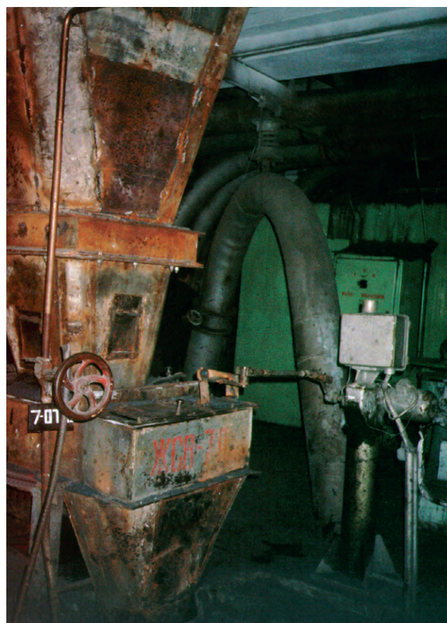
Рис. 6. Питатель сырого угля тепловой электрической станции
