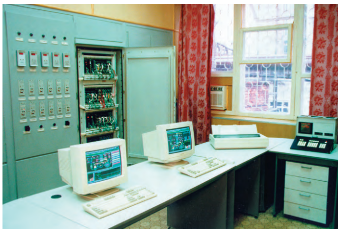
Рис. 2. Помещение операторов АСУ ТП
