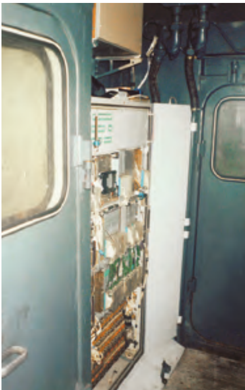
ЦБУ АПК «Пилот» в процессе эксплуатационных испытаний
