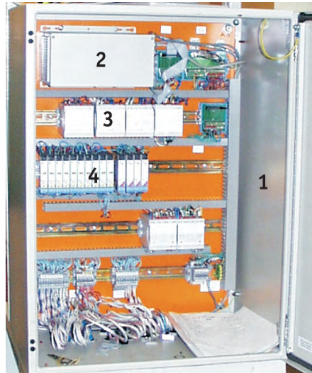
Рис. 7. Локальная технологическая станция системы измерения уровня и температуры (1 — электротехнический шкаф серии CONCEPTLINE фирмы Schroff/Hoffman, 2 — контроллер PCA 6145B в корпусе MBPC641 фирмы Advantech, 3 — блоки питания системы, 4 — барьеры искрозащиты фирмы Elcon)
