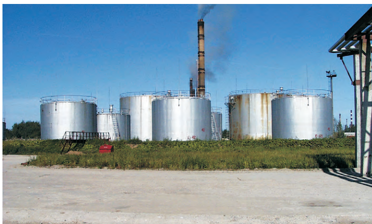
Резервуары топлива на нефтебазе КИНЕФ
