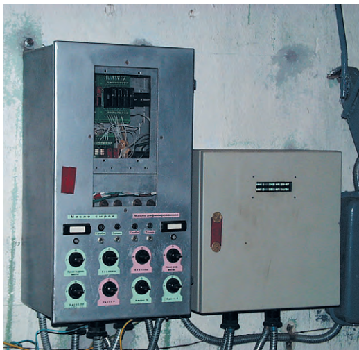
Рис. 3а. Локальная станция в цехе
