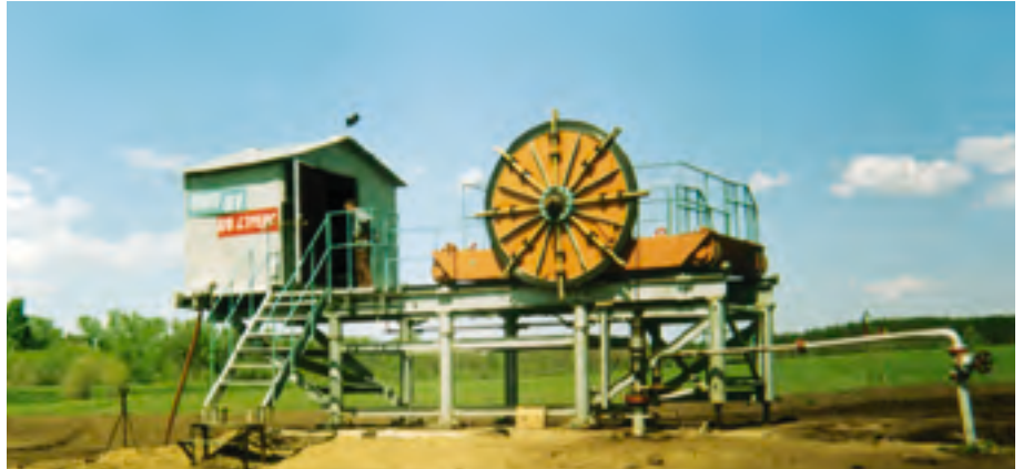
Рис. 2. Общий вид длинноходовой насосной установки
