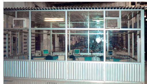
Объединенный пункт управления диффузионной установкой, выпарной станцией и станцией дефекоосатурации (ЗАО «Кристалл-Бел»)
