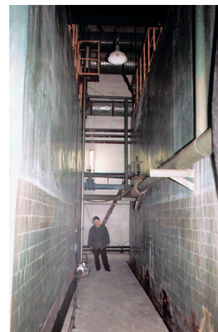
Рис. 1. Расходные баки блока реагентного хозяйства
