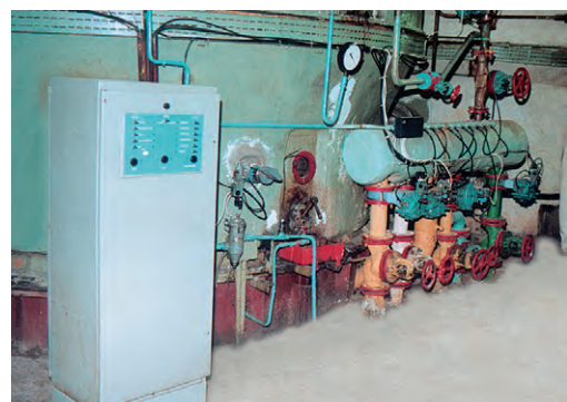
Датчики и исполнительные устройства системы автоматизации вакуум-аппарата
