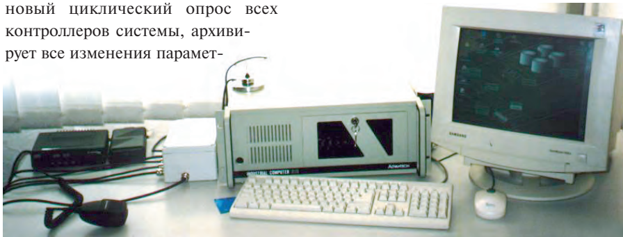
Рис. 3. Оборудование диспетчерского пункта
