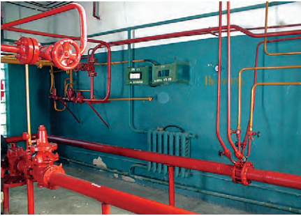
Рис. 1. Оборудование ГРП: трубки-отводы для датчиков
