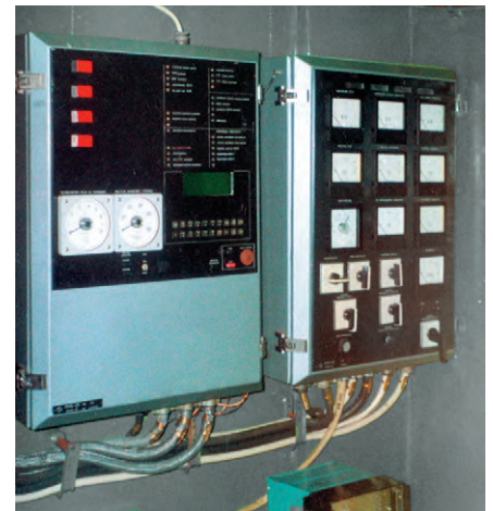
Рис. 5. ПУД и ПУГ в блоке управления электростанции
