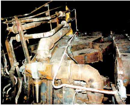
Рис. 2. Стенд сушки и разогрева сталеразливочных ковшей
