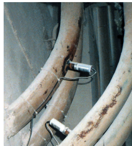
Рис. 2. Датчики закачки на входных трубах силосов
