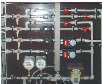
Рис. 13. Гидропанель ввода воды
