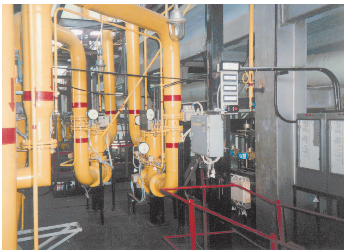
Рис. 1. Оборудование и аппаратура системы, расположенные на технологической площадке перед котлом КВГМ-100
