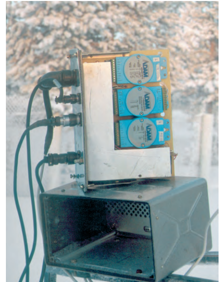
Рис. 5. Аппаратура федеральной метеостанции на базе модулей ADAM и термостатируемый конструктив
