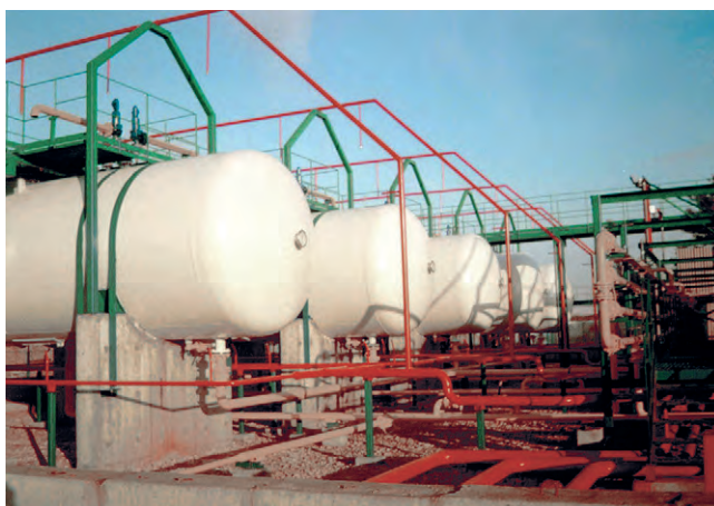
Рис. 1. Резервуарный парк базы хранения газонаполнительной станции
