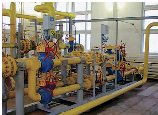
Газораспределительная станция, участок измерения расхода газа
