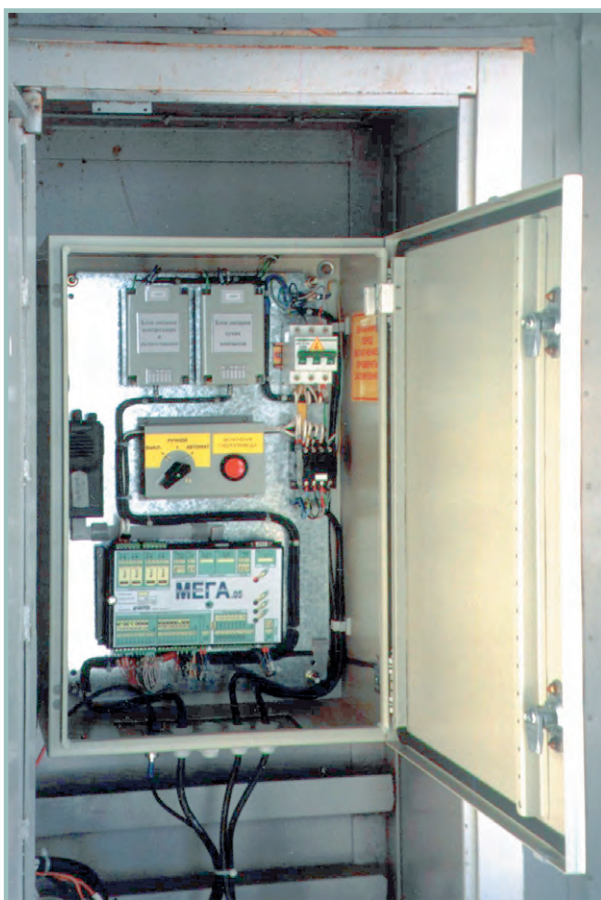
Рис. 3. Контроллер «Мега» в составе оборудования контролируемого пункта ГЗУ
