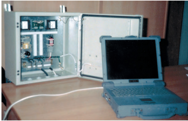
Рис. 3. Рабочая станция и шкаф устройства ввода-вывода
