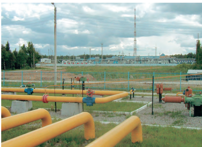
Вид на компрессорную станцию
