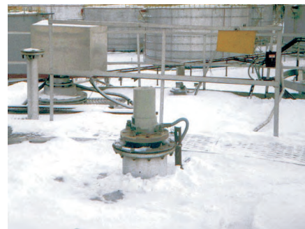
Рис. 1. Размещение уровнемера в герметичном корпусе на фланце резервуара с внешней стороны
