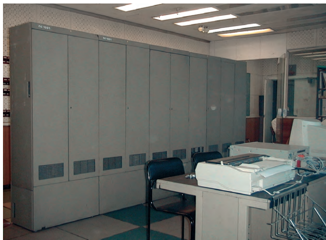
Рис. 2. Шкафы с аппаратурой ПВДС и ПВССУ
