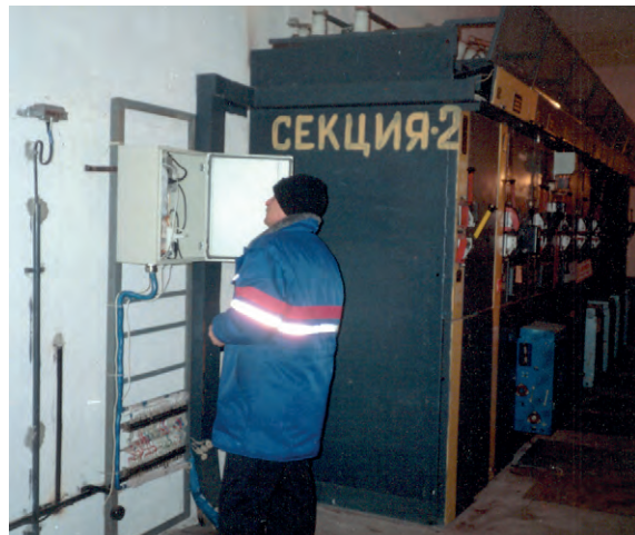
Рис. 9. Разработанные на базе устройств MicroPC контроллеры успешно эксплуатируются в условиях неотапливаемых помещений РП
