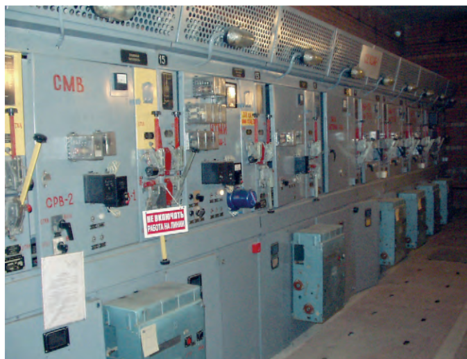
Оборудование распределительного пункта (РП)
