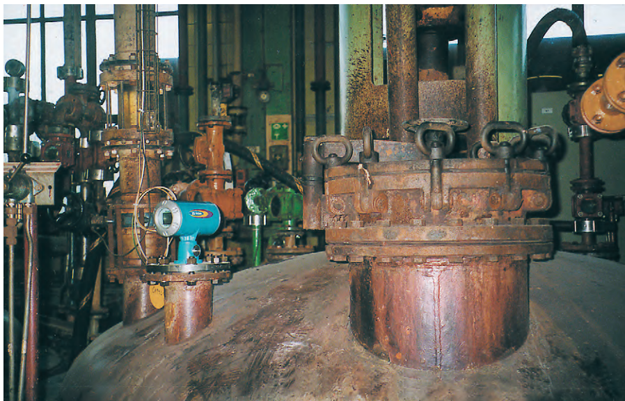
Рис. 1. Исполнение точек доступа внутрь резервуара (патрубки, стояки и трубы) определяет, какие приборы могут быть применены, а также способ и место их монтажа
