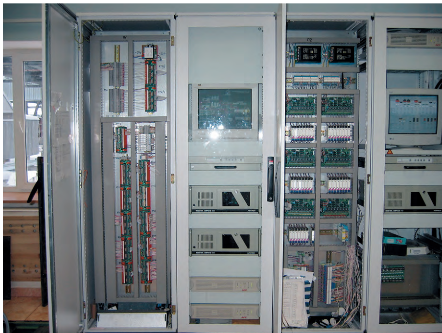
Рис. 2. Стойки с оборудованием сбора данных и управления
