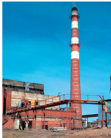
Рис. 2. Утилизационная котельная Краснокамского целлюлозно-бумажного комбината
