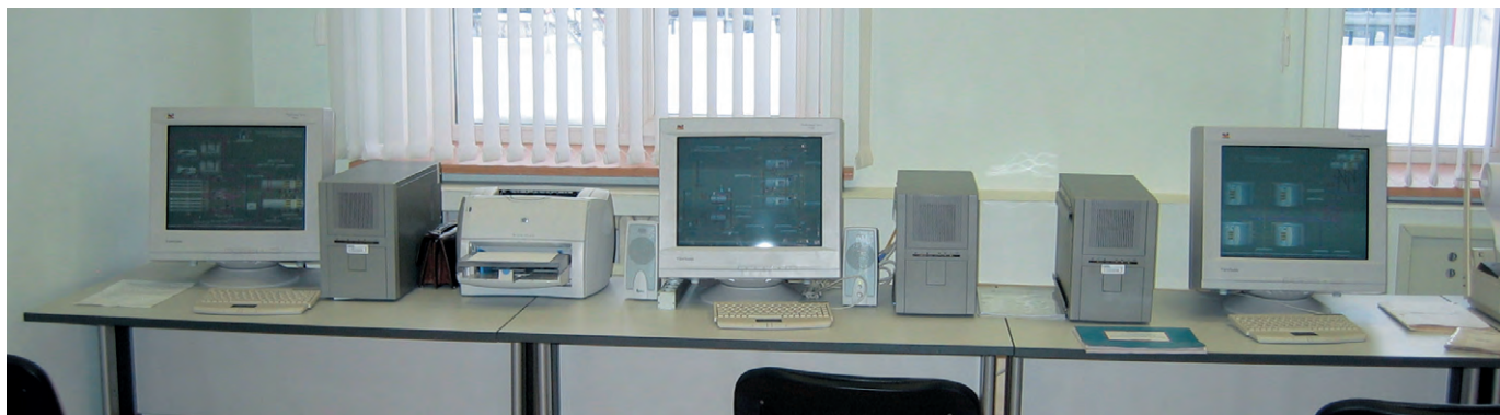
Рис. 3. Операторские станции (WS1 и WS2) и компьютер БКНС (WS3) в настольном исполнении на базе шасси IPC-6908
