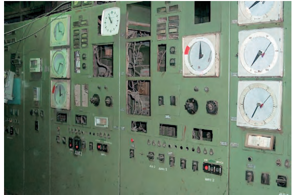
Рис. 9. Щит управления котлом до реконструкции
