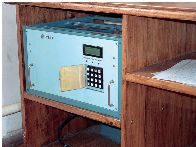
Рис. 9. Устройство обработки и управления УОУ-7683 на диспетчерском пункте
