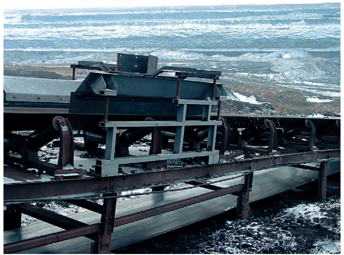
Рис. 8. Формирователь потока угля на конвейерной ленте, установленный перед датчиком зольности ГДЗ-7683
