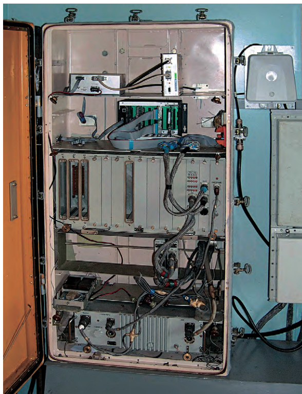
Рис. 6. Размещение УУКТ в контейнере блок-бокса контролируемого пункта системы СЛТМ-СК
