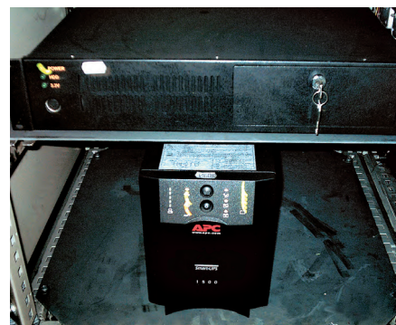
Рис. 4. Размещённые в шкафу управляющая станция и источник бесперебойного питания
