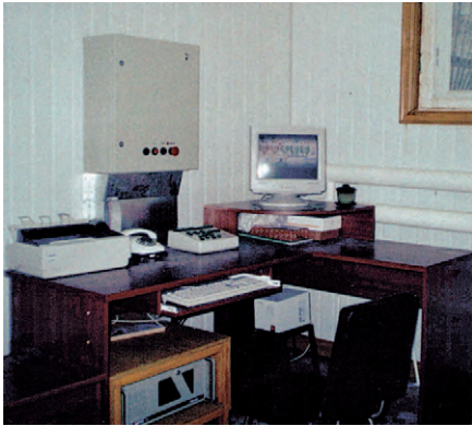
Рис. 9. Индустриальный компьютер и шкаф управления в помещении операторской
