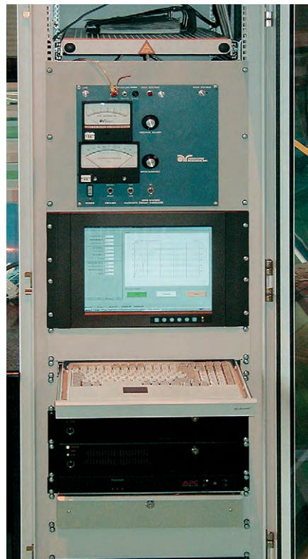
Рис. 10. АРМ оператора станда тестирования погружного электродвигателя
