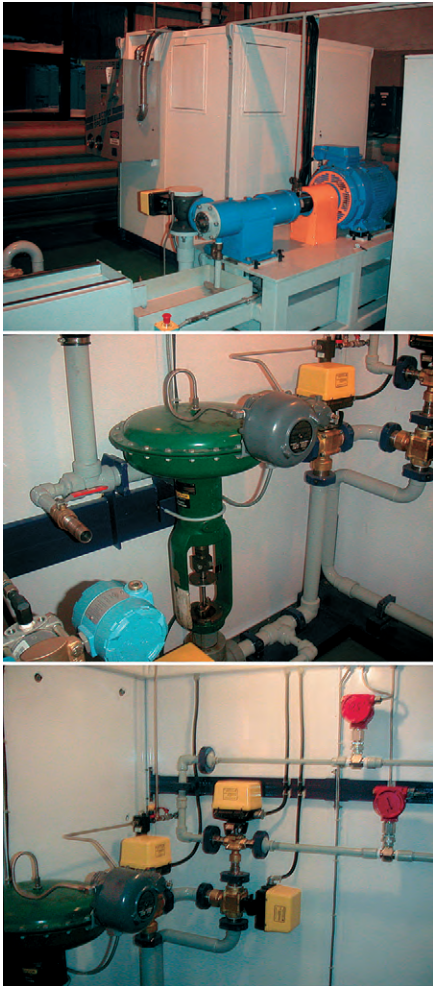
Рис. 2. Оборудование измерительного блока
