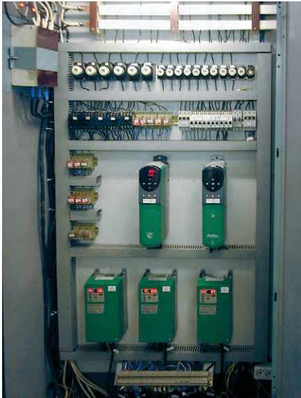
Рис. 2. Силовой шкаф управления экструзионной линией на базе частотных регуляторов UniDrive и SE-Commander
