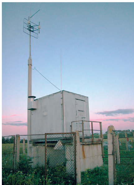
Контролируемый пункт магистрального газопровода
