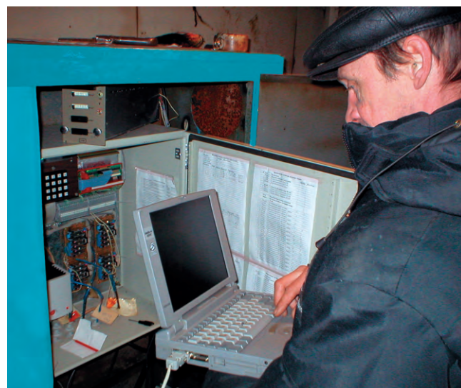
Рис. 3. Периферийное устройство регистрации с открытой крышкой шкафа
