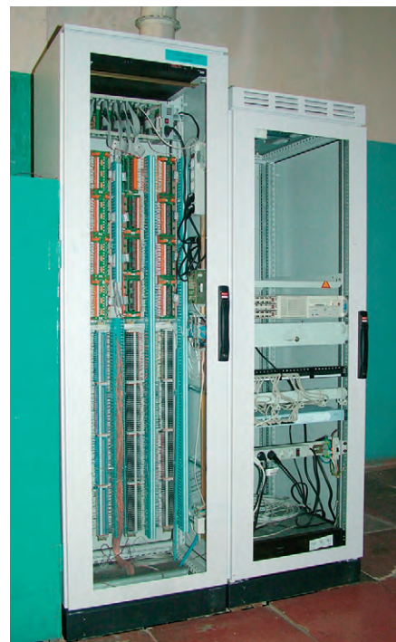
Рис. 3. Шкаф контроллера регистрирующего и шкаф файлового сервера
