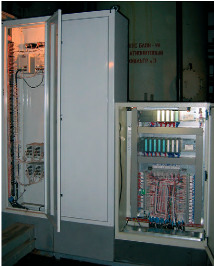
Рис. 3. Шкафы контроллера и вторичных приборов блока фильтров
