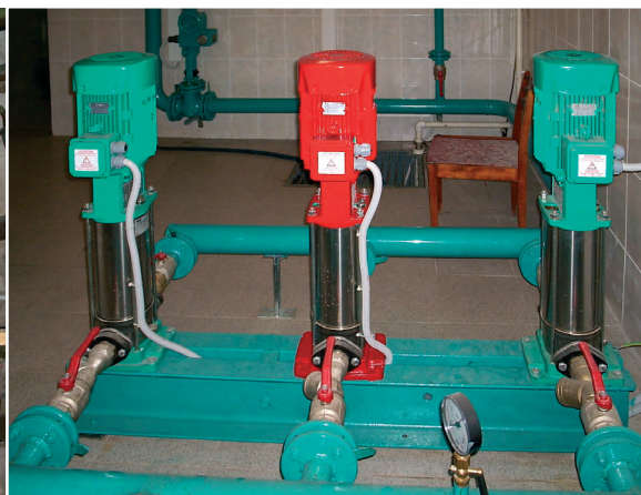
Рис. 6. Подающие насосы новой насосной
