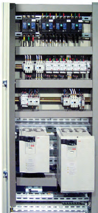
Рис. 3. Размещение оборудования системы управления в шкафу
