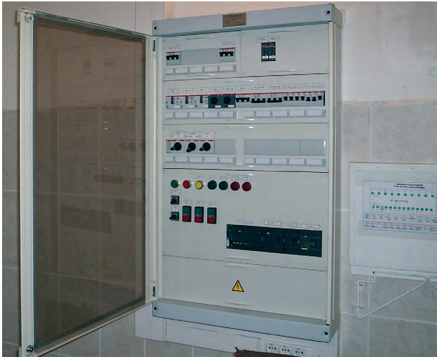
Рис. 3. Щит ЩА-1 в помещении насосной
