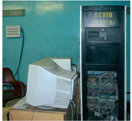
Рис. 3. Внешний вид шкафа управления с центральным контроллером, реализованным на базе промышленного шасси IPC-623
