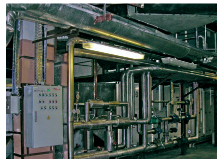
Полностью автоматизированная система водоподготовки
