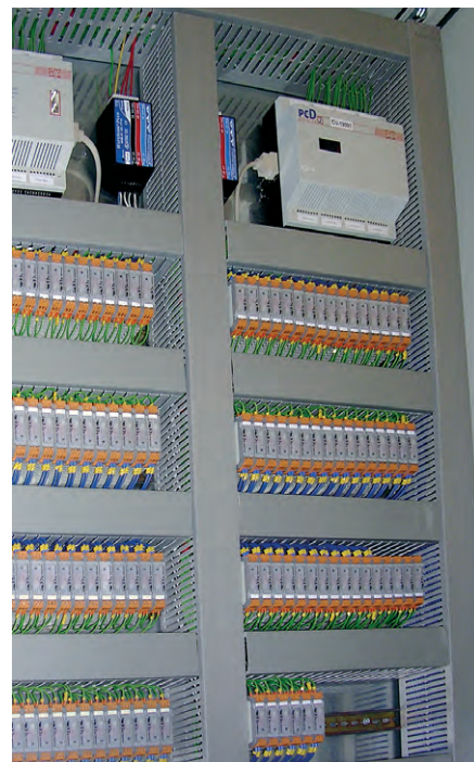
Рис. 5. Один из шкафов системы управления с программируемыми контроллерами и измерителями параметров тока и напряжения
