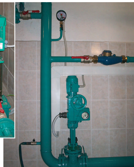
Рис. 7. Обводная задвижка, водомер и электроконтактный манометр
