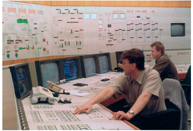
Вид блочного щита
