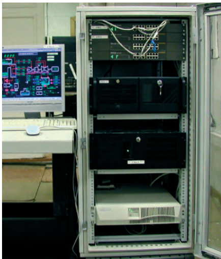
Рис. 7. Общий вид шкафа
