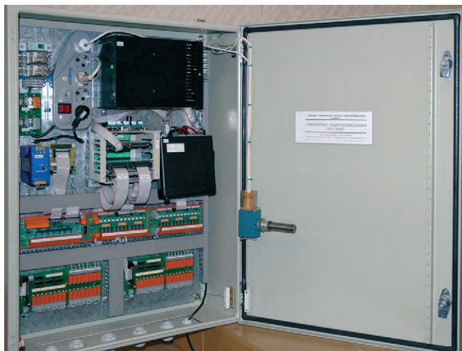
Рис. 5. Шкаф с оборудованием субкомплекса телемеханики СК-ТМ
