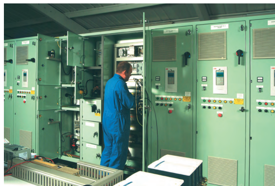
Квалифицированные специалисты XP Power осуществляют разработку систем электропитания по спецификациям заказчика, монтаж оборудования и сопровождение
