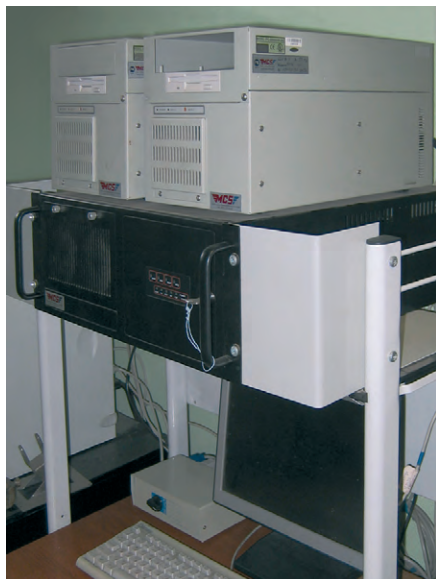
Рис. 8. Промышленные компьютеры Advantech из состава оборудования АСУ ТП
