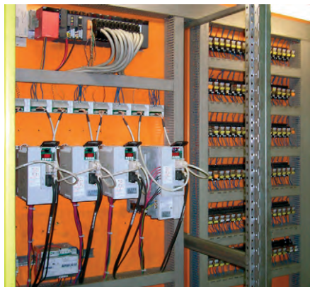
Шкаф управления АПЛ
