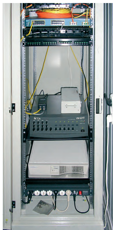
Рис. 5. Устройства системы РИДОП в станционной консоли
