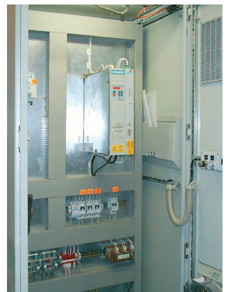
Рис. 5. Общий вид шкафа управления приводом крышки
