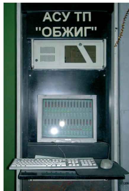
Рис. 4. Стойка управления обжиговой печи
