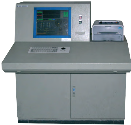
Рис. 2. Рабочая станция дежурного электрика обжимного цеха
