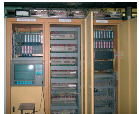
Рис. 5. Шкафы контроллеров «Обжиг» и «Транспорт печи»
