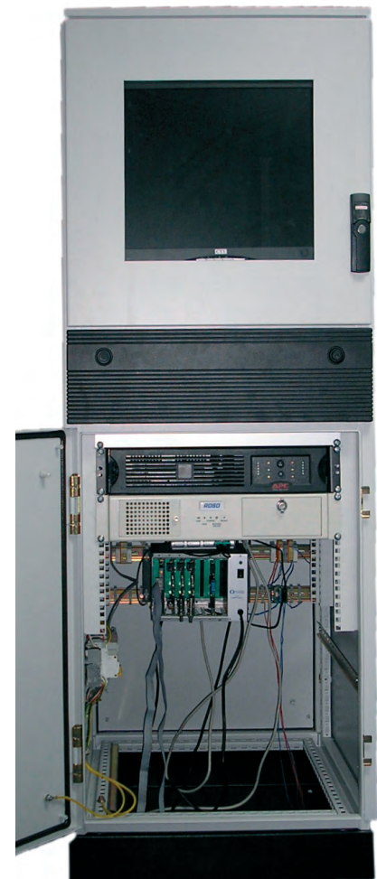
Рис. 3. Размещение устройств в индикаторном шкафу
