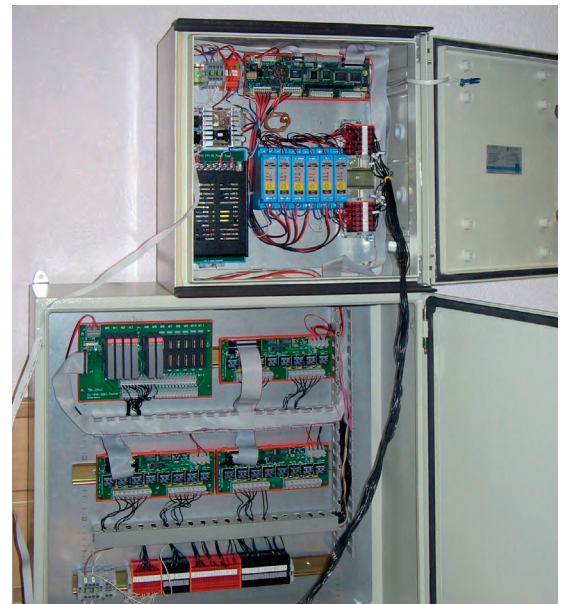
Рис. 2. Блок контроллера БСУ
