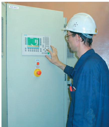
Рис. 6. Панель оператора OP 270, расположенная на двери шкафа управления стендом сушки
