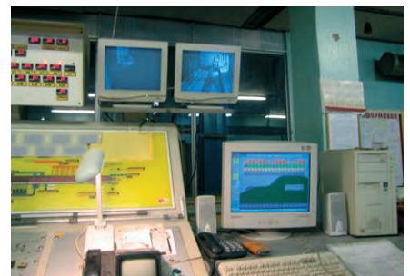
Рис. 4. Вид пульта оператора и станции WinCC
