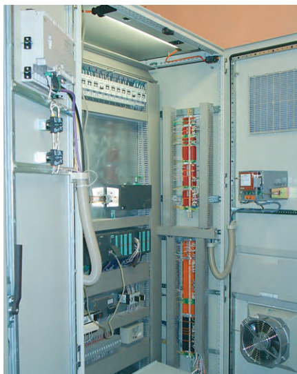
Рис. 7. Общий вид шкафа управления стендом сушки
