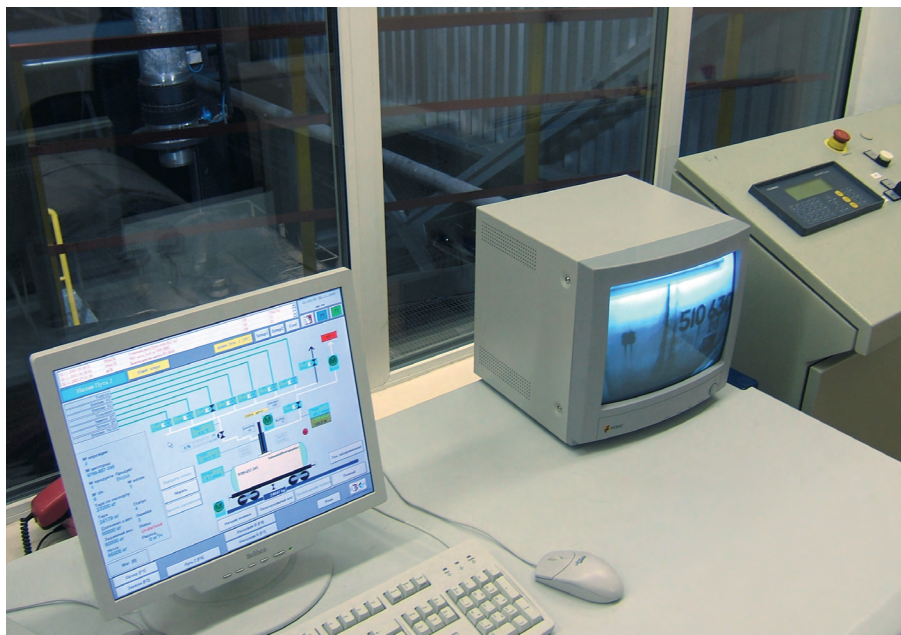
Рис. 5. Оборудование АРМ оператора
