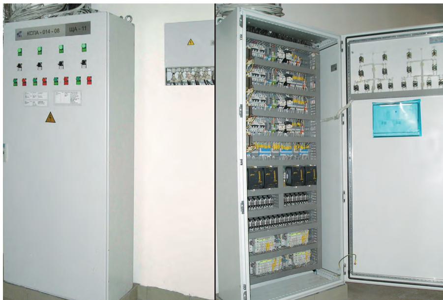
Рис. 2. Шкаф системы управления вентиляционной установкой
