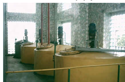
Рис. 2. Технологический участок гидроферментативной обработки крахмала (низкотемпературной варки)
