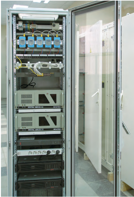
Рис. 4. Общий вид шкафа системы автоматизации вентиляторной градирни
