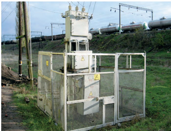
Рис. 1. Комплексная трансформаторная подстанция — энергообъект АСКУЭ ЖУ
