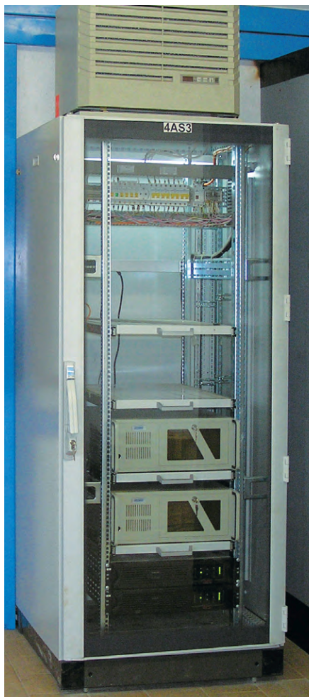
Рис. 4. Шкаф Rittal с промышленными компьютерами
