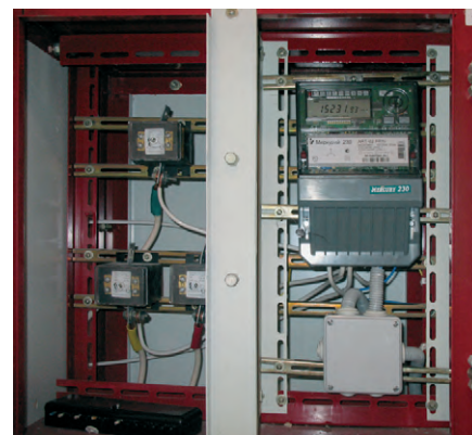
Рис. 3. Счётчик потребления электрической энергии лифтами и системой освещения
