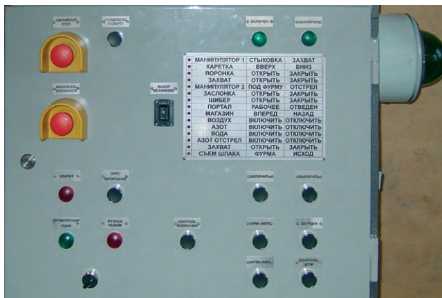
Рис. 4. Шкаф местного управления ПМУ-31
