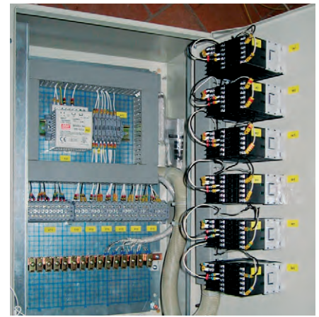
Рис. 4. Внешний вид шкафа управления системы автоматизации БСУ НПФ «Ракурс»
