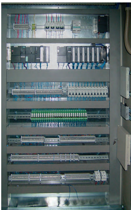
Рис. 3. Шкаф системы управления
