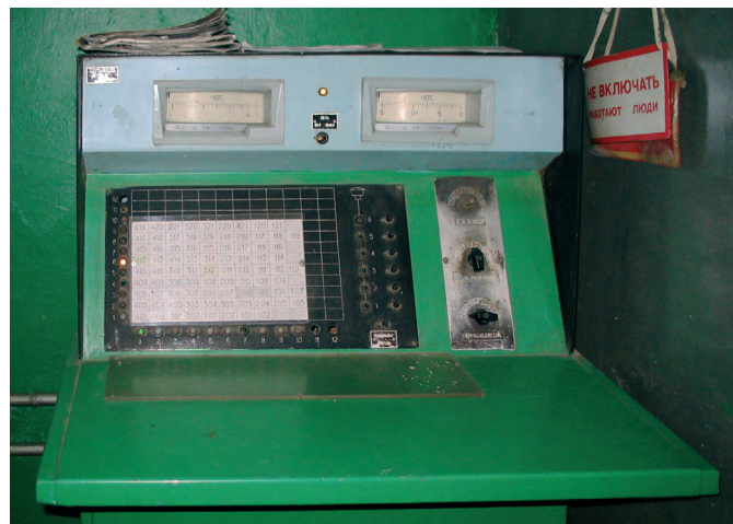
Рис. 2. Пульт управления устаревшей системы ДКТЭ-4М
