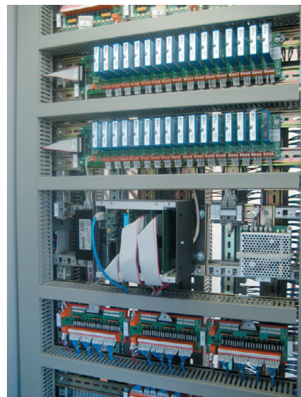
Рис. 5. Контроллер MicroPC установлен в каждом шкафу САУ ГСП
