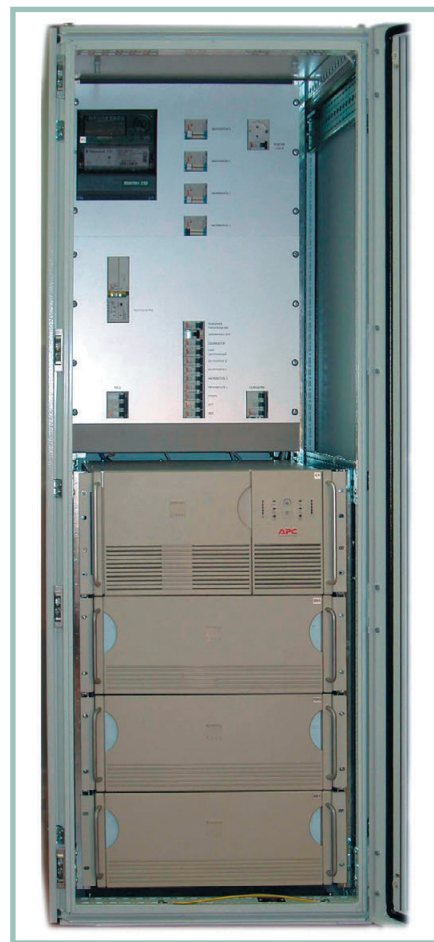
Рис. 3. Щит распределительный САУ ГРС
