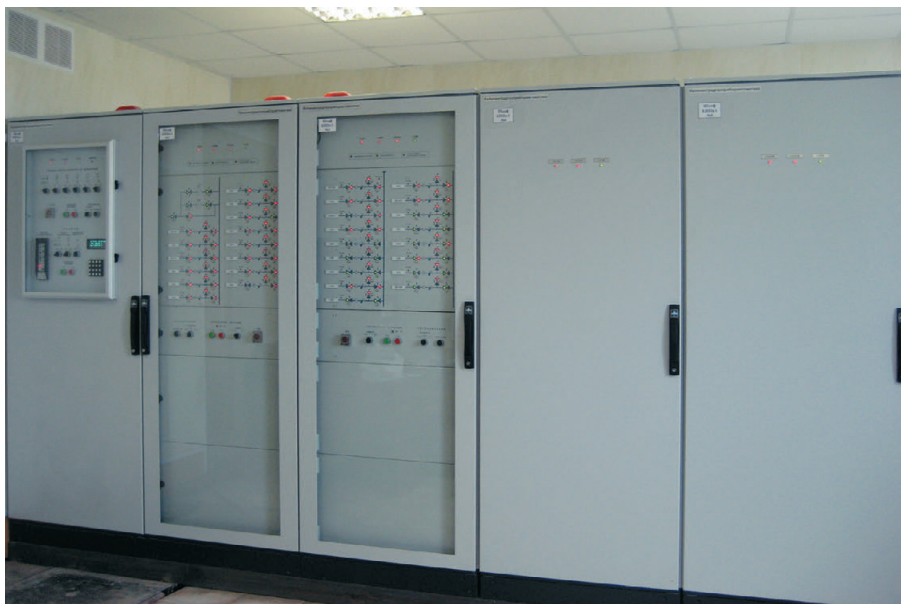
Рис. 4. Шкафы с аппаратурой САУ ГСП
