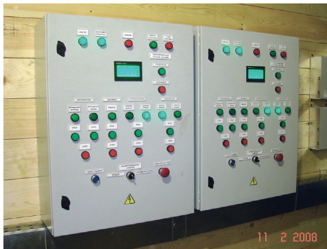
Рис. 1. Внешний вид шкафа автоматизации ША-ЛСК-04
