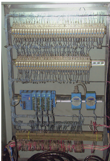
Рис. 5. Общий вид шкафа контроллера смесильной машины
