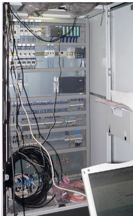
Рис. 4. Общий вид шкафа управления станком
