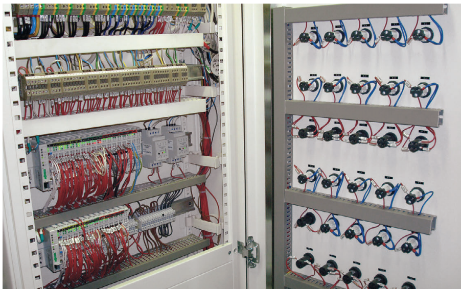
Рис. 7. Внешний вид шкафа локальной автоматики системы вентиляции
