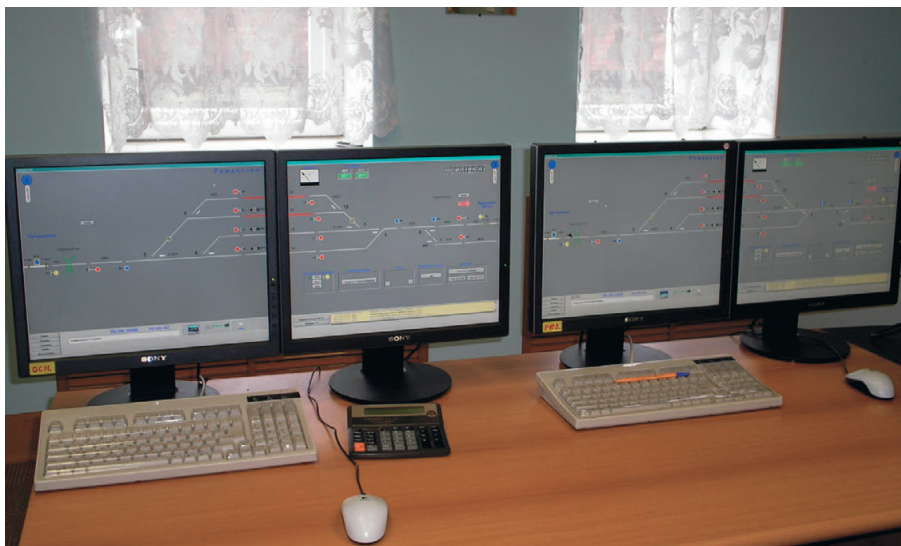
Рис. 1. Автоматизированное рабочее место дежурного по станции (основное и резервное)
