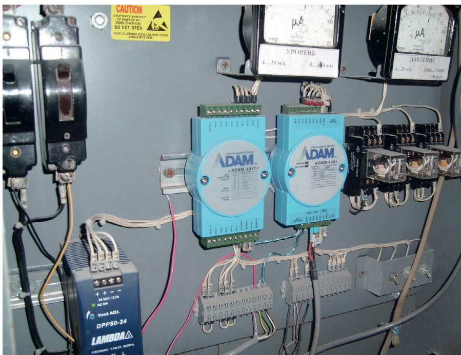
Рис. 7. Внешний вид приборов шкафа КИП
