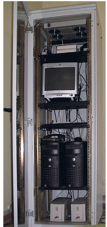
Рис. 6. Серверная стойка центрального диспетчерского пункта
