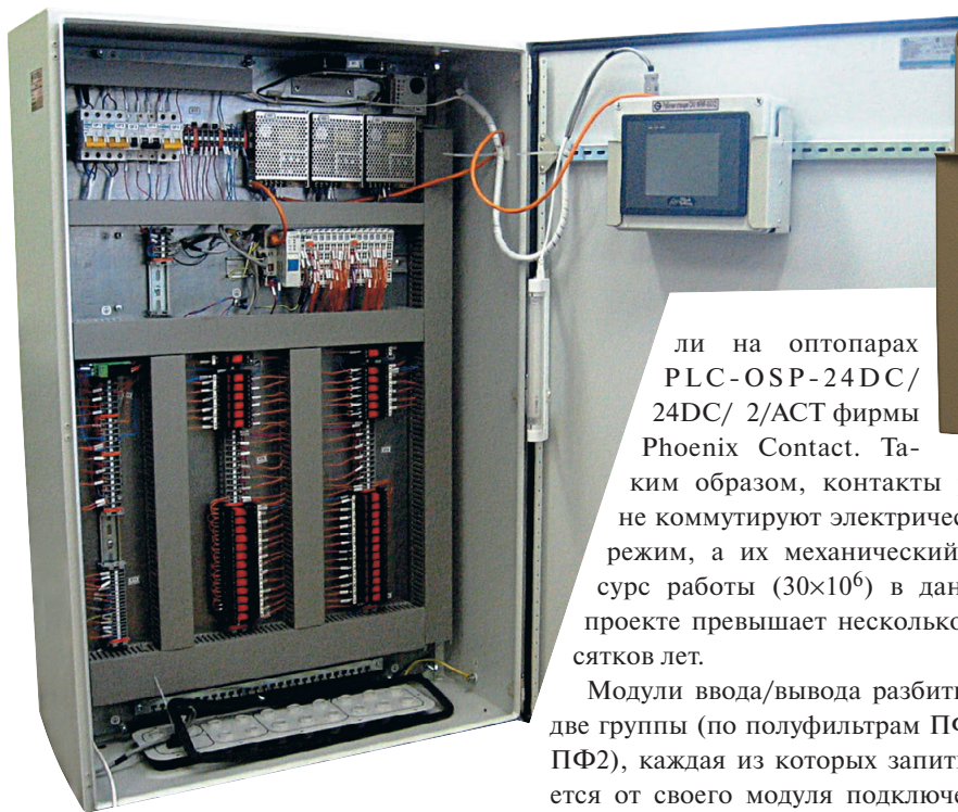
Рис. 3. САУ ФРИР 800x2 с рабочей станцией внутри шкафа
