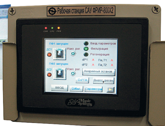
Рис. 5. Рабочая станция САУ ФРИР 800x2 с главным видеокладом
