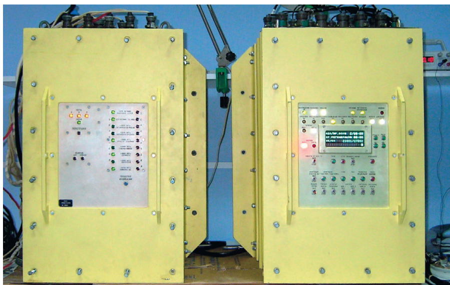
Рис. 1. Оборудование системы автоматического управления компрессорной станции: слева – шкаф силовой (ШС), справа – прибор управления электрокомпрессором и блоком осушки (ПУ ЭКБО)
