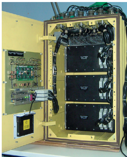
Рис. 2. Прибор управления электрокомпрессором и блоком осушки
