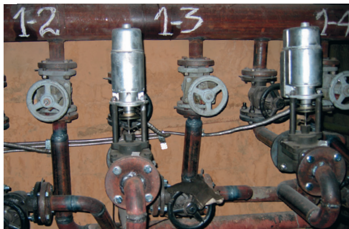
Рис. 4. Электроклапаны, установленные на паропроводе
