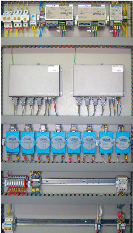
Рис. 3. Шкаф контроллеров и средств коммуникаций
