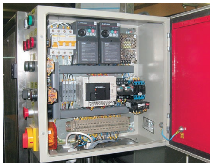
Рис. 4. Пример монтажа контроллера FX3G, а также преобразователей частоты FR-D700 в шкафу управления укупорочной машины
