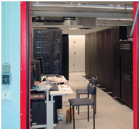
Рис. 1. Интерьер модульной комнаты безопасности Lampertz
