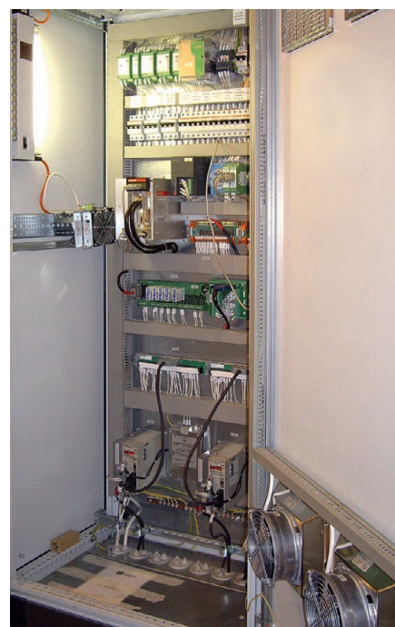
Рис. 6. Щит системы управления
