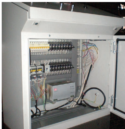
Рис. 4. Электрооборудование системы, установленное на монтажной панели пульта
