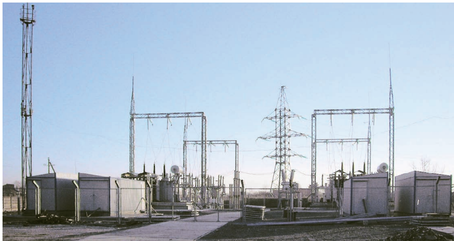
Рис. 2. Подстанция ПС-110/10/6кВ «Энергомаш» (энергетический комплекс в г. Крымске)
