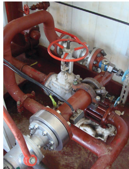
Рис. 7. Установка зондирующего блока влагомера «Сател-РВВЛ» в сливном трубопроводе из измерительной ёмкости АГЗУ «Мера»
