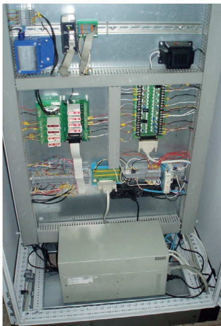
Рис. 1. Оборудование щита управления варочного отделения
