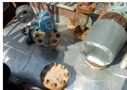
Рис. 1. Rosemount 5300 смонтирован на выпарном аппарате установки сероочистки в успокоительной трубе вместо буйкового уровнемера
