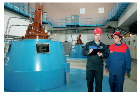
Рис. 2. Машинный зал станции: оперативный персонал рядом с возбудителем и втулкой маслоприёмника гидроагрегата
