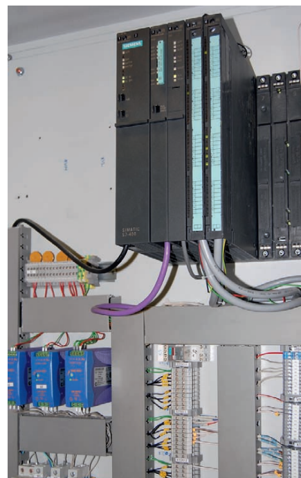
Рис. 3. Контроллер SIMATIC S7-414-2 в составе оборудования системы управления ЦПП
