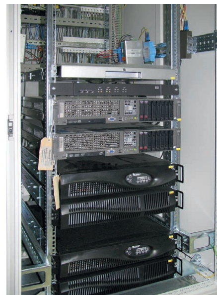
Рис. 7. Общий вид шкафа серверов СТМ
