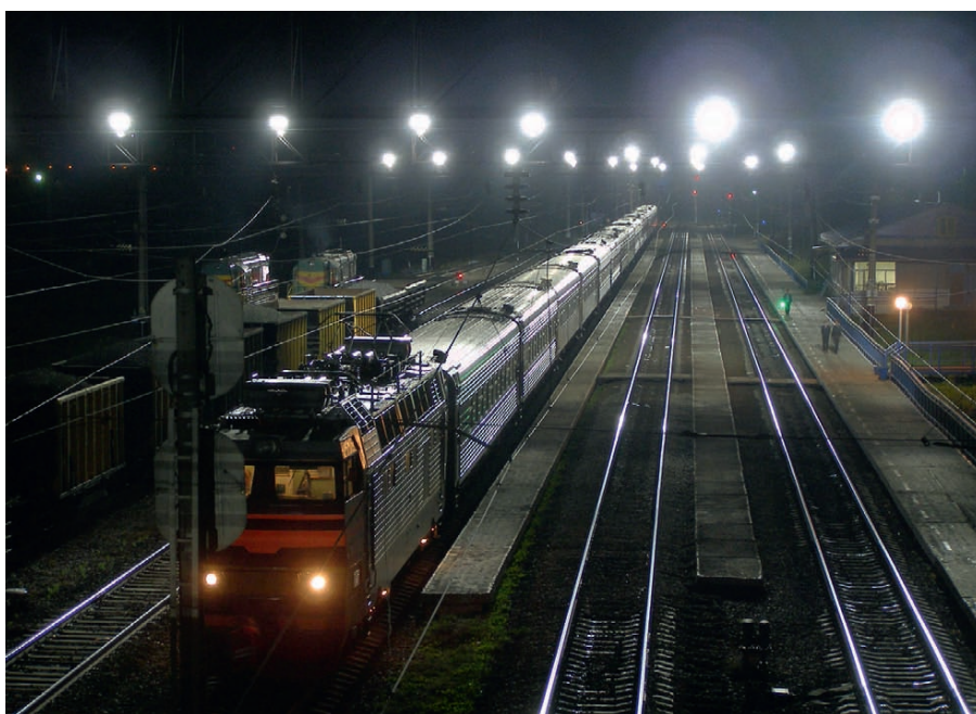
Рис. 6. Освещение станции Шексна Северной железной дороги светильниками на основе светодиодов Cree
