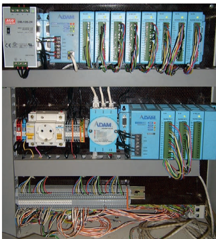
Рис. 6. Шкаф автоматики сбора данных с удалённых локальных объектов на базе контроллера ADAM-5000/TCP
