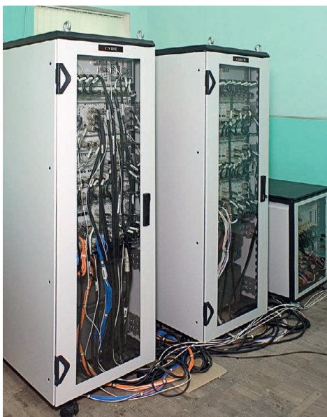
Рис. 3. Стойки АИС в процессе настройки и испытаний
