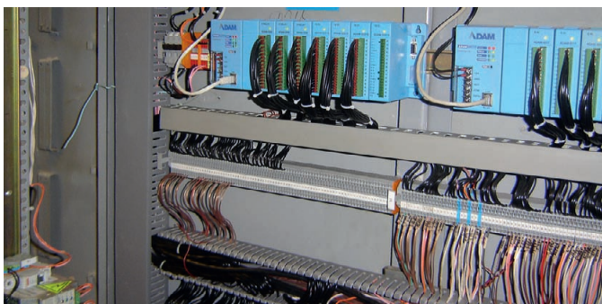
Рис. 4. Часть основного шкафа автоматики, укомплектованная контроллерами ADAM-5000/EKW, отвечающими за реализацию централизованного управления
