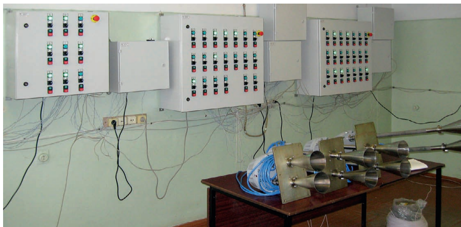
Рис. 3. Шкафы управления на этапе проведения испытаний
