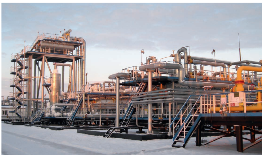
Рис. 1. Установка комплексной подготовки газа
