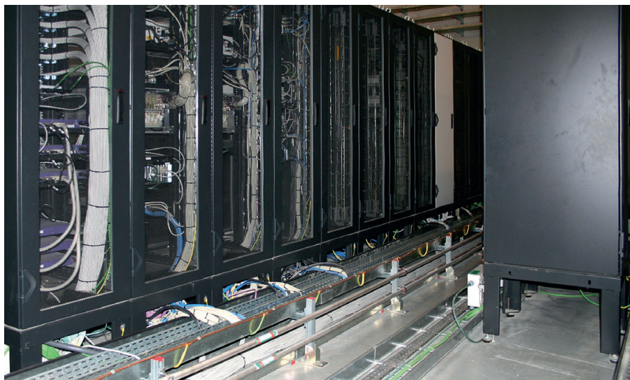
Рис. 2. Одним из требований к шкафам был цоколь высотой 50 см, необходимый для создания фальшпола
