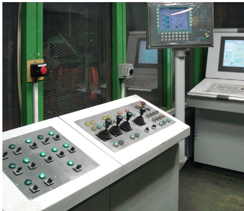
Рис. 2. Пульт управления в диспетчерском пункте (на заднем плане видны панели оператора, относящиеся к устройствам человеко-машинного интерфейса верхнего уровня системы управления)
