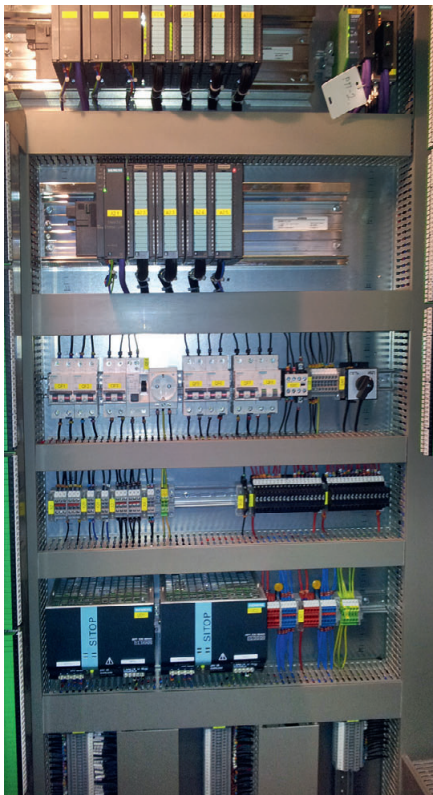
Рис. 2. Станции распределённого ввода-вывода ET200M в составе оборудования шкафа управления РП-102
