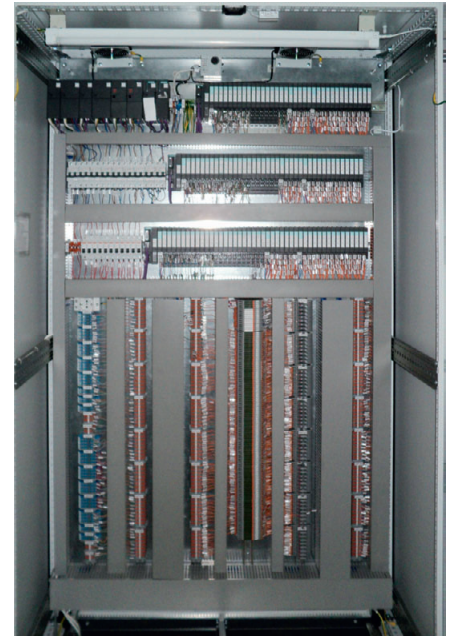
Рис. 3. Контроллерный шкаф АСУ ТП ГОТ К2
