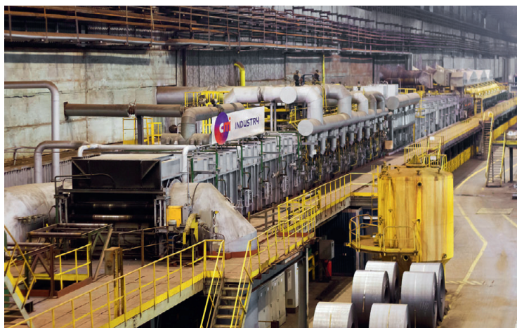
Рис. 1. Общий вид реконструированной линии нормализационного отжига
