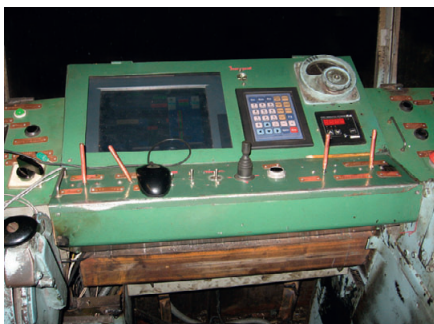
Рис. 4. Операторская станция с функциональной клавиатурой на главном посту управления
