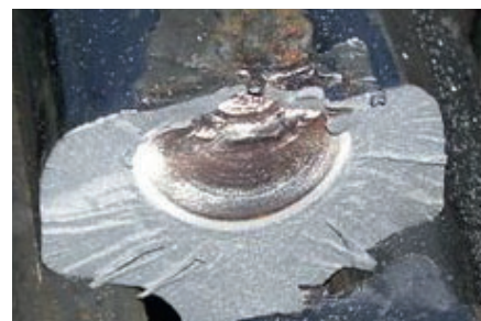
Рис. 5. Развитие поперечной трещины от повреждения на поверхности катания головки рельса
