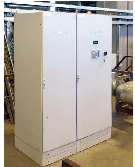
Рис. 2. Внешний вид шкафов с оборудованием ЭЧСРиЗ, установленных на одном из объектов
