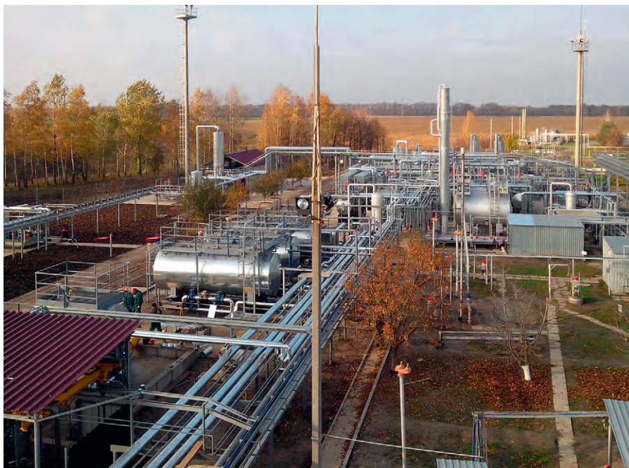
Рис. 2. Установка комплексной подготовки газа
