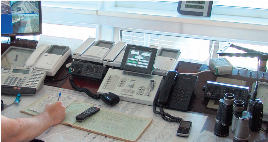
Рис. 8. Панель оператора в ЦПУ шлюза
