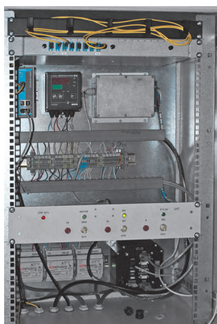
Рис. 4. Шкаф контроллера управления и дополнительных устройств
