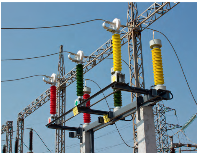
Рис. 1. Комплект ВОПТН на подстанции «Магистральная» 220 кВ
