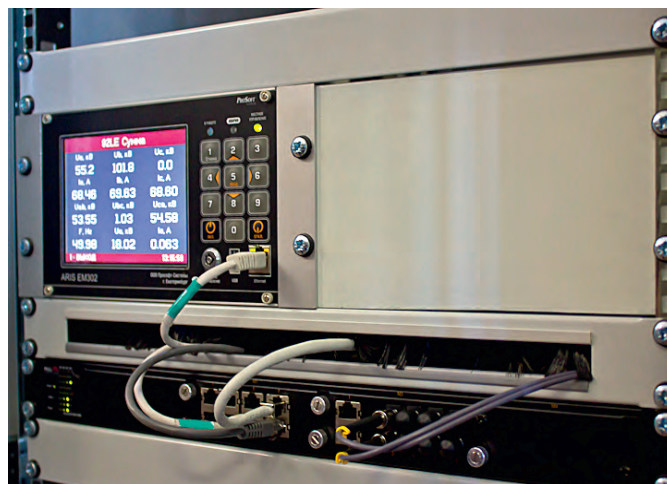
Рис. 2. ARIS EM302 с интерфейсом МЭК 61850-9-2LE на подстанции «Магистральная» 220 кВ
