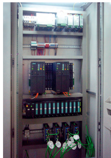
Рис. 9. Шкаф управления с резервированным контроллером S7-416-5H
