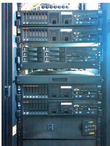
Рис. 4. Серверный шкаф рудника
