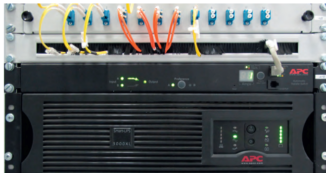
Рис. 9. Серверная стойка с ИБП APC Smart-UPS 3000XL
