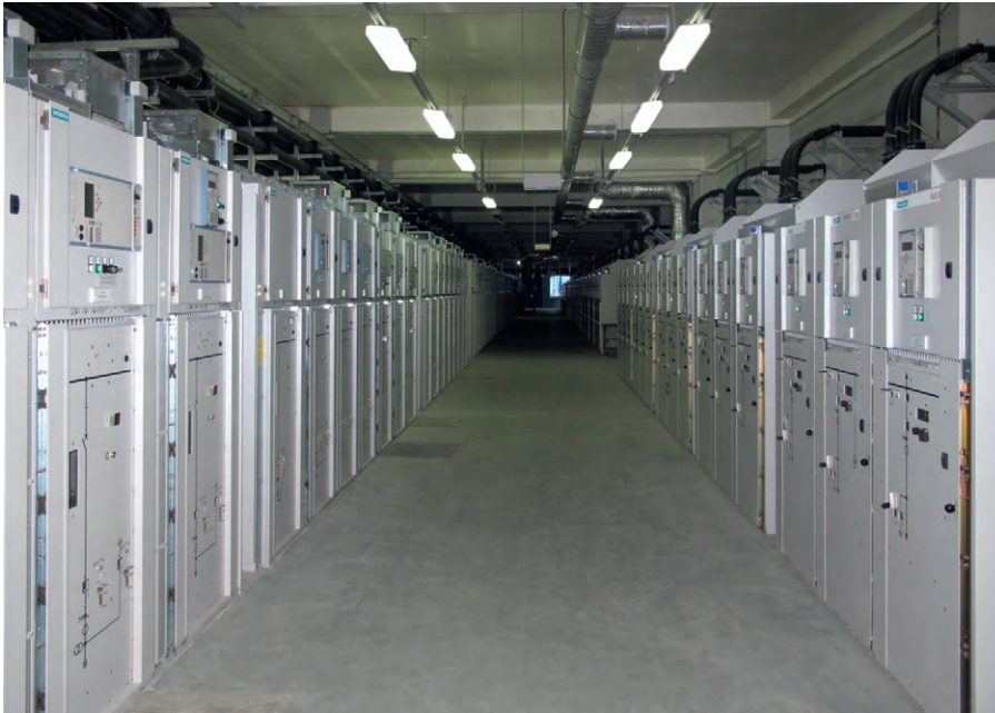
Рис. 6. Подстанция ПГВ-2, закрытые распределительные устройства 6 кВ
